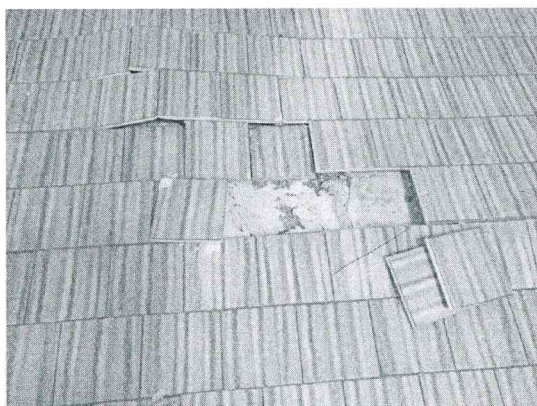
Foto n° 4 dettaglio parti danneggiate
